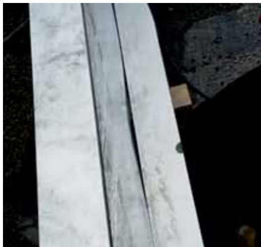
Typischer lokaler Verzug bei flächigen, feuerverzinkten Elementen. Der Verzug ist verfahrenstechnisch bedingt und innerhalb der zulässigen Norm.
