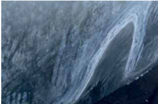
Beispiel: Weißrost an einer Sitzbank nach falscher Zwischenlagerung auf der Baustelle.
